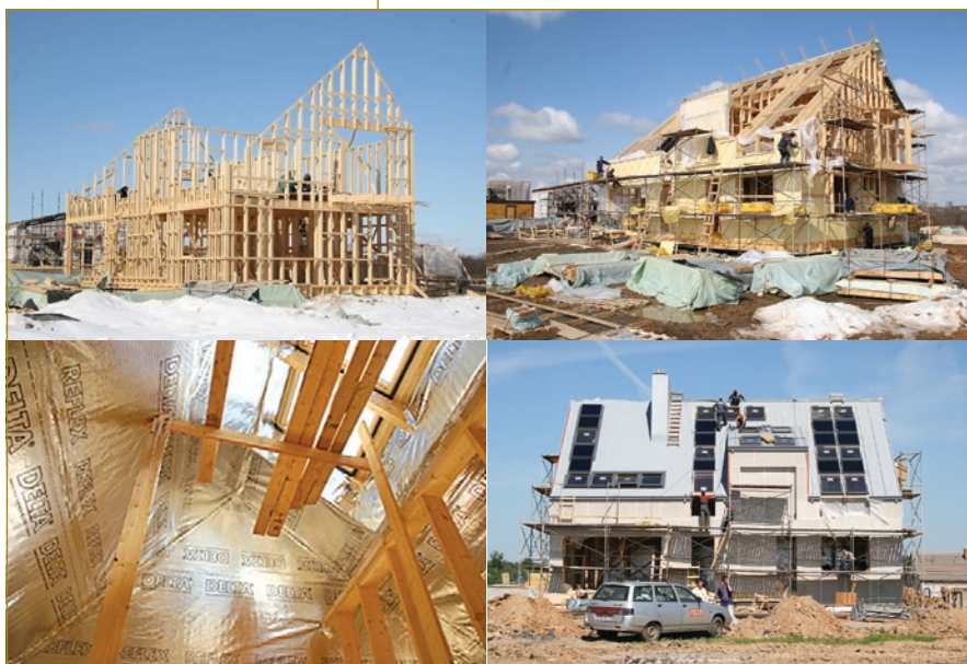
Рис. 10 Строительство объекта: возведение каркаса, утепление здания, устройство пароизоляции, установка мансардных окон и солнечных коллекторов.
