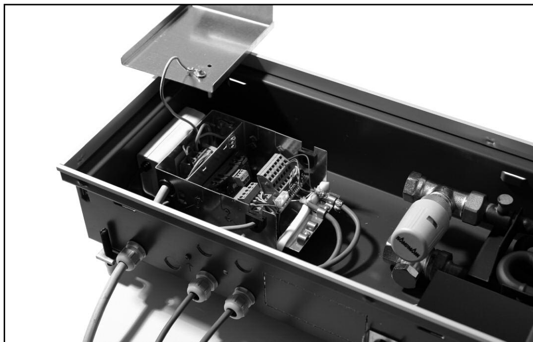
Рис. Клеммная коробка с кабелями для подключения к сети:
